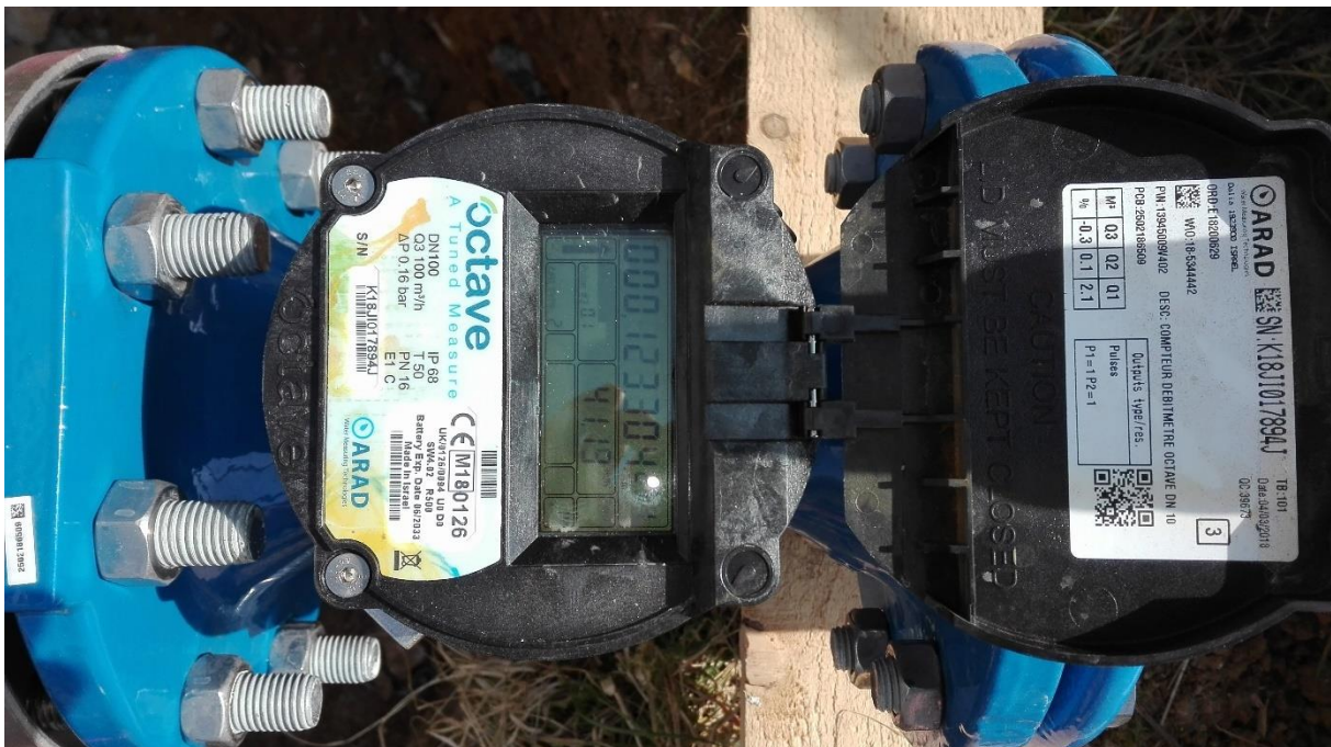
Photo 2 : Compteur débitmétrique sur la conduite de refoulement
